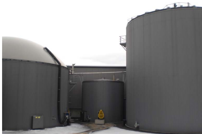
post digester und digester
